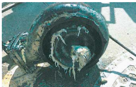
△タオルが絡まって停止したポンプ
