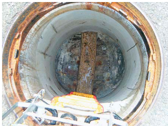
△油脂の堆積で閉塞寸前のマンホール
