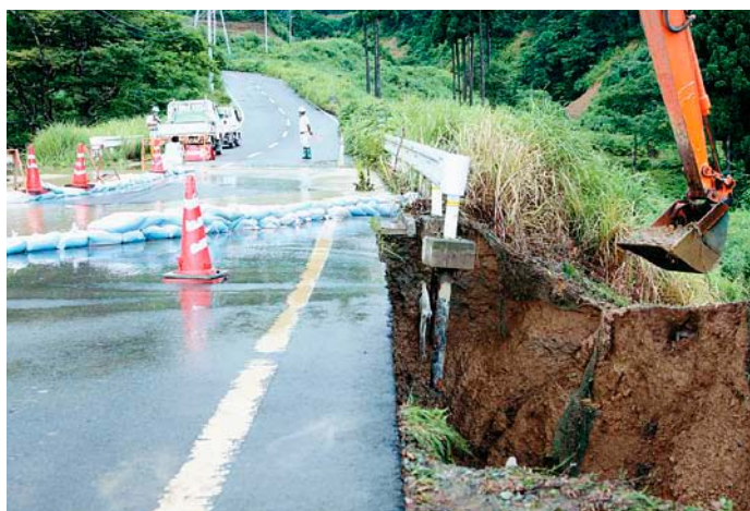
△路肩が崩落した道路 (冬井地内)
