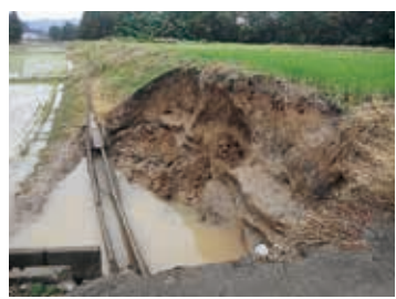
△法面が崩れた水田（木津）
