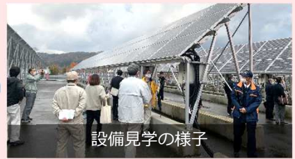
屋上に設置された太陽光パネル
