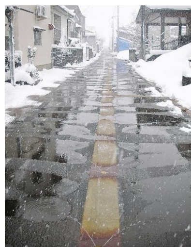
整備された消雪パイプ
