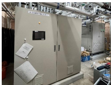
錦鯉の里の地中熱ヒートポンプ
