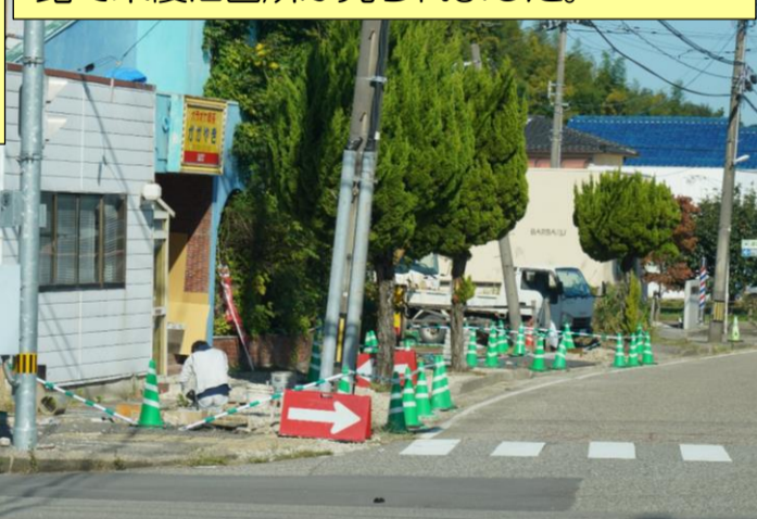
道路は概ね復旧済みでしたが、一部の道路で未復旧箇所が見られました。
