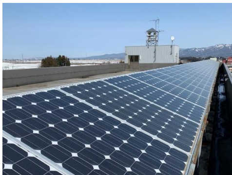
片貝総合センターの太陽光パネル
