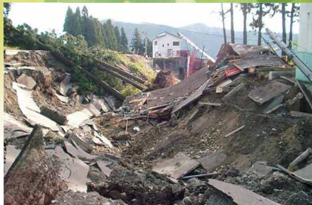
地盤が崩壊した水道施設(卯ノ木)
