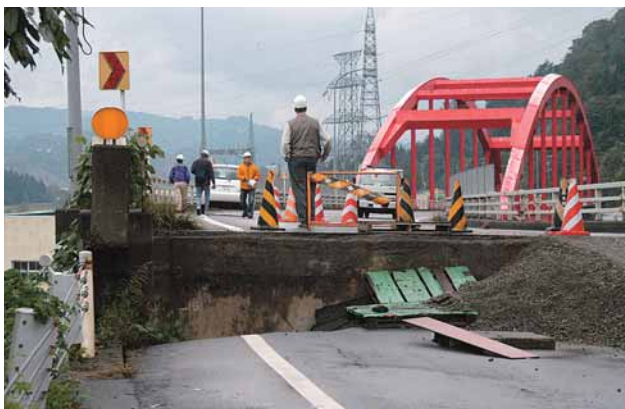
国道117号山辺橋付近の欠壊(山本)
